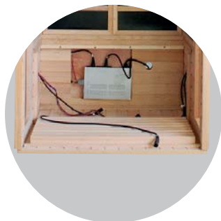
Umístění podlahového topidla
